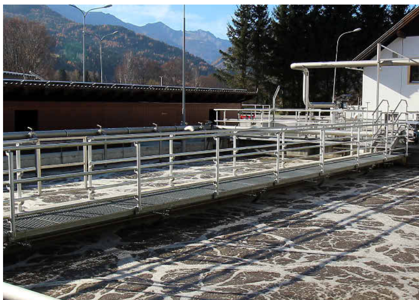
Mit einem modernen Gebläse wird das Belebungsbecken dieser Kläranlage bis zu 30 % effizienter betrieben. PV-Module und ein BHKW sollen für Energieautarkie sorgen. Foto: Aerzen
