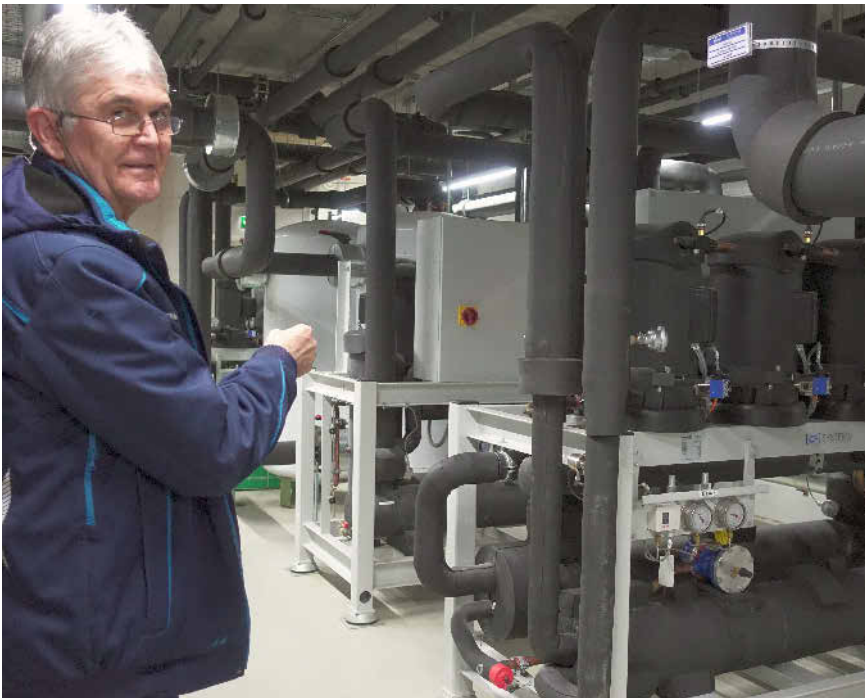
Josef Harrer , geschäftsführender Inhaber von Josef Harrer Kältetechnik, vor der Wärmepumpen-Anlage im Untergeschoss der Carderie. Hier wird die mit Geothermie gewonnene, aus der Tiefe stammende Wärme auf das erforderliche Temperaturniveau gebracht und auf die Fußbodenheizung übertragen. Bei Bedarf im Sommer wird dieselbe Technik zum Kühlen des Gebäudes verwendet. Foto: König
