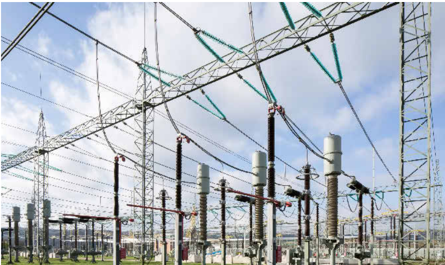
Mit Netzboostern soll das Verteilnetz stabilisiert werden. Foto: Amprion/Schumann
